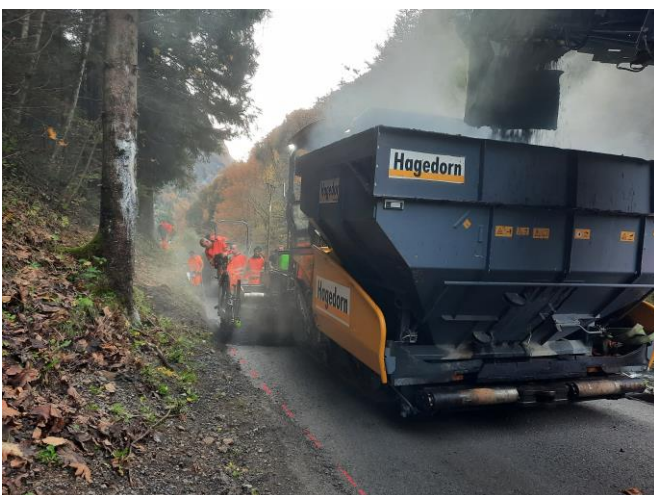
TS 2 am 17.10.2024: Einbau Tragschicht zwischen Cholplatz und Gewerbe Balm. Über 50 Lastwagen haben den Asphalt transportiert. Einbau von 7:30- 19:00 Uhr.
