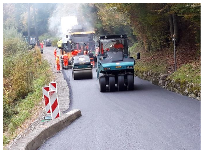
TS 2 am 17.10.2024: Einbau Tragschicht im Bild oberhalb Höch Murä. Es wurden über 1000 Tonnen Belag eingebaut.
