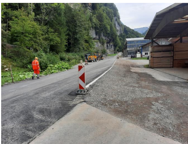
TS1: Einbau Belag Tragschicht süd. Fahrbahn von Brücke schlichende Brünnen bis Gewerbe
